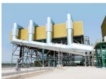
VZDUCEM CHLAZENÉ KONDENZÁTORY
